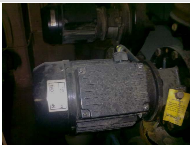
Foto dell'impianto rilevate in sopralluogo
